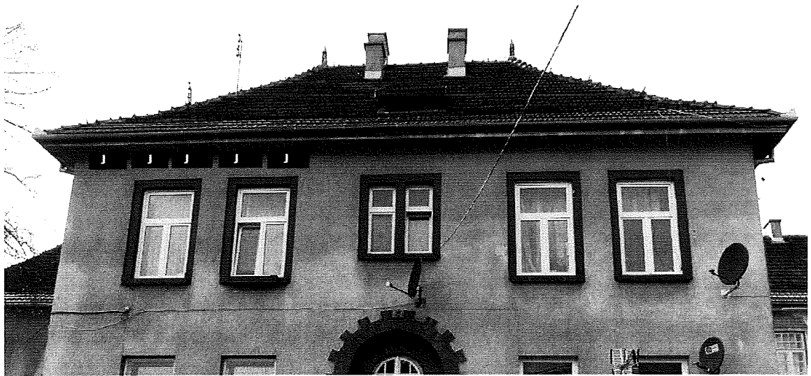
Fot. 14. Kraków, ul. Babińskiego 29, budynek nr 19, ściana wschodnia segmentu II, pięć czarnych prostokątów z literą J wskazuje miejsca zamocowania podwójnych budek z okapem dla jerzyków.
