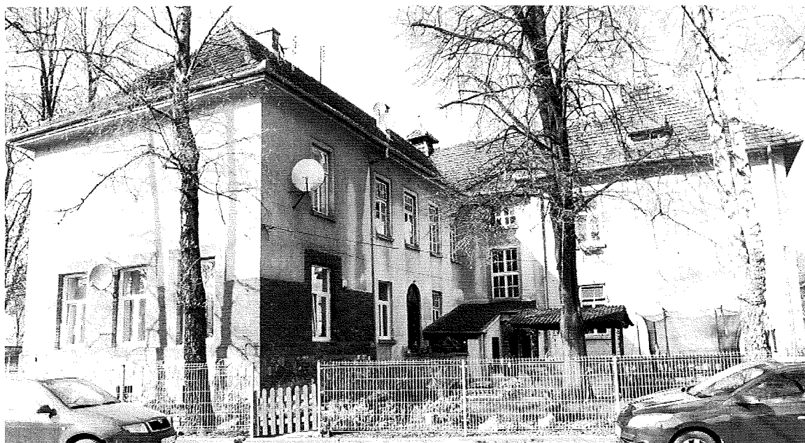
Fot. 4. Kraków, ul. Babińskiego 29, budynek nr 19, elewacja południowa i wschodnia segmentu I, elewacja południowa segmentu II.
