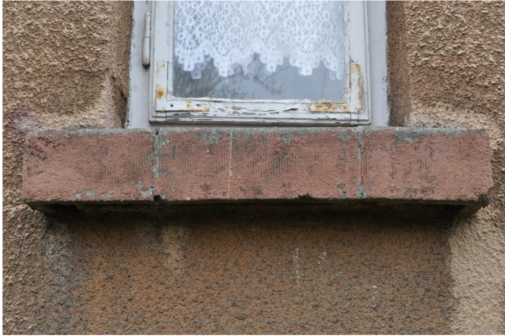
Fot.12 i 13. Góra: nierówna kolorystyka przez zalewanie elewacji woda opadową. Dół: odspojenia tynku na całej grubości od podłoża ceglanego. Maj 2021r. aut. N. Soran – Maluty.
