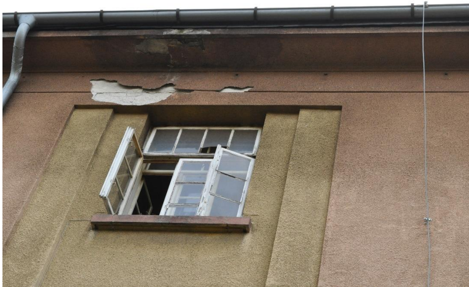
Fot.31 i 32. Góra: widoczny zły stan tynków na elewacji tylnej. Dół: zły stan tynków na elewacji tylnej. Piony okienne w prostokątnych płycinach o zdwojonych uskokowo bocznych brzegach; gzyms, wieńczący, plintowy, nad gładkim, wyodrębnionym drobnym uskokiem fryzem. Maj 2021r. aut. N. Soran – Maluty
