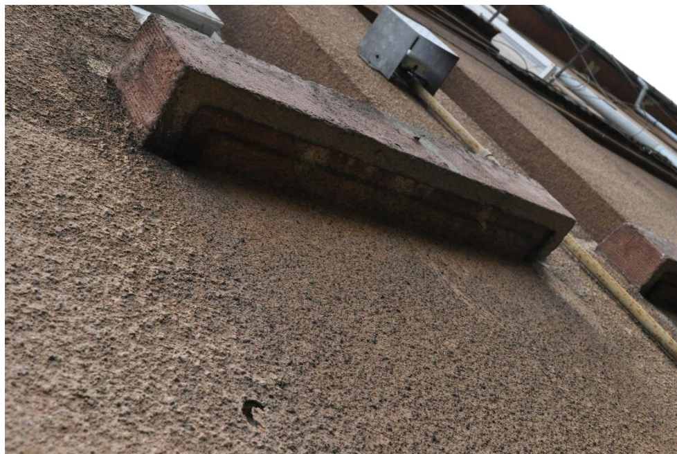
Fot.8 i 9. Góra: Fragment elewacji tylnej, tynk cementowy, barwiony w masie, odspojony od podłoża, mocno zabrudzony. Dół: rozległe odparzenia tynku od podłoża, widoczne poziome spękania, po nich następuje odpadanie płatami. Maj 2021 aut. N Soran - Maluty
