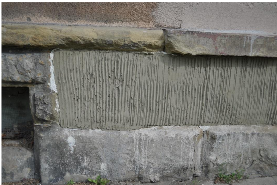
Fot.33 i 34. Góra: nieudolna próba rekonstrukcji płycin grzebykowanych w cokole. Dół: naprawy cokołu wykonane niezgodnie z pierwotnymi , w obrębie okienka piwnicznego – elewacja frontowa. Maj 2021r. aut. N. Soran - Maluty
