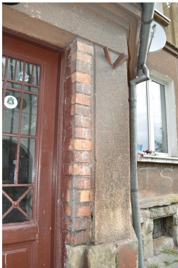
Fot.35. Prawy węgar prawego ryzalitu budynku 20 częściowo wykonany z cegły zendrówki z fugowaniem. Maj 2021r. aut. N. Soran –Maluty.
