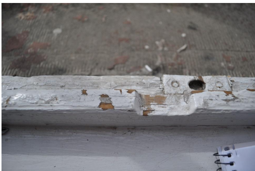
Fot.4. W naturalnej odkrywce na dolnej części ościeżnicy okna na klatce schodowej w prawym ryzalicy budynku, widoczny jest zachowany fragment najstarszej na stolarce warstwy lakierniczej oznaczonej w stratygrafii nr 3/I ( ?). Maj 2021r. aut. N. Soran - Maluty
