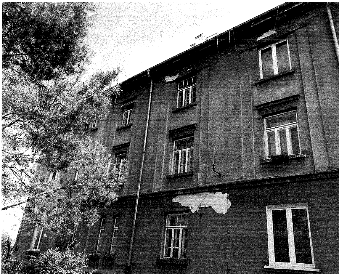
Fot. 4. Kraków, ul. Babińskiego 29, budynek nr 20, elewacja północna.
